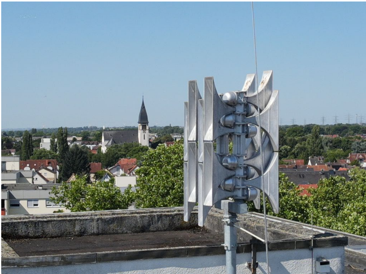
Neue Sirenenanlage auf dem Dach eines Wohnhochhauses.
