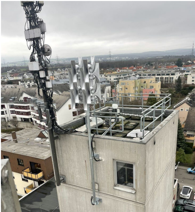
Neue Sirene EWS 16 auf dem Schlauchturm der Feuerwehr (elektronisch und digital)
