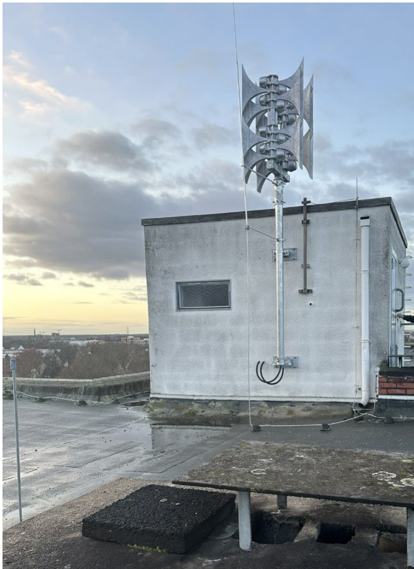
EWS 16 auf dem Gebäude der Hawobau in der Hans-Riggenbach-Straße (elektronisch und digital)
